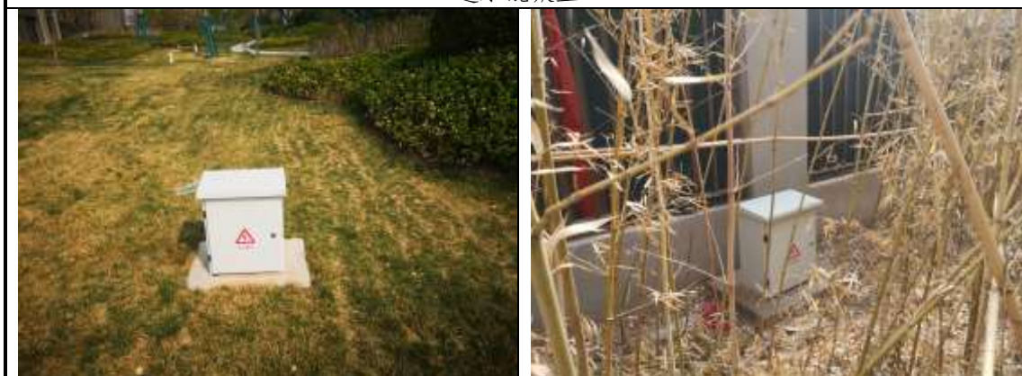
雨水调蓄池配电箱
