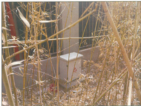
雨水调蓄配电箱
