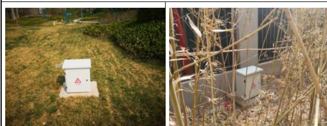
雨水调蓄池配电箱
